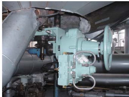
☆反応釜底弁の自動化(特殊取付例)
