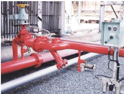
☆消火設備ラインの自動遠隔化
